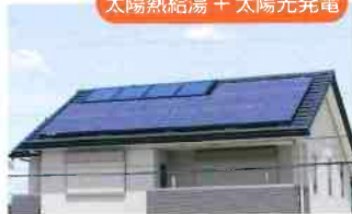
太陽熱給湯 + 太陽光発電
